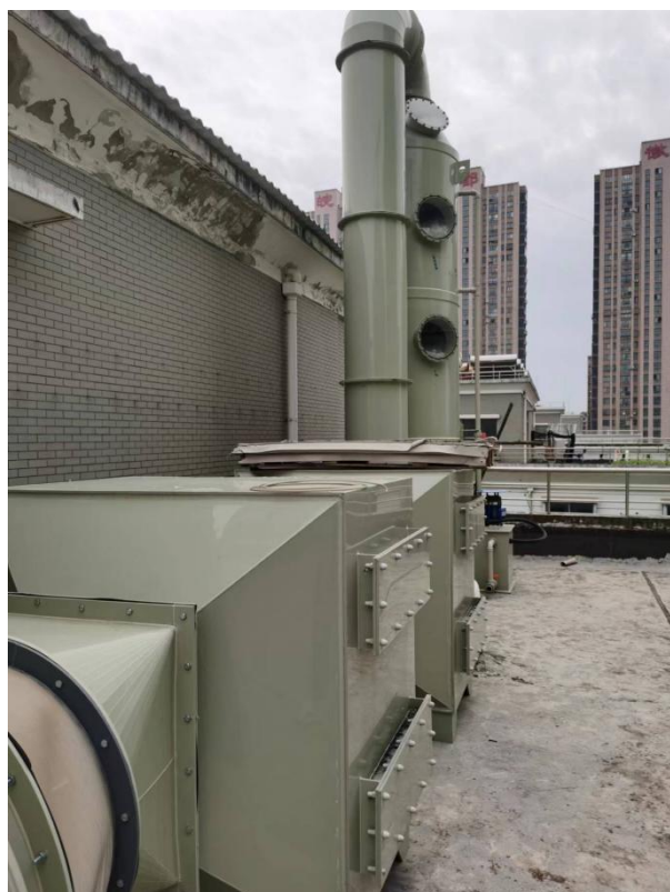
废气处理装置
