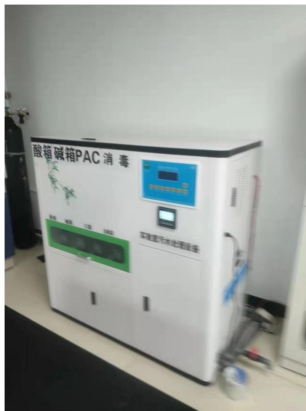
污水处理设施
